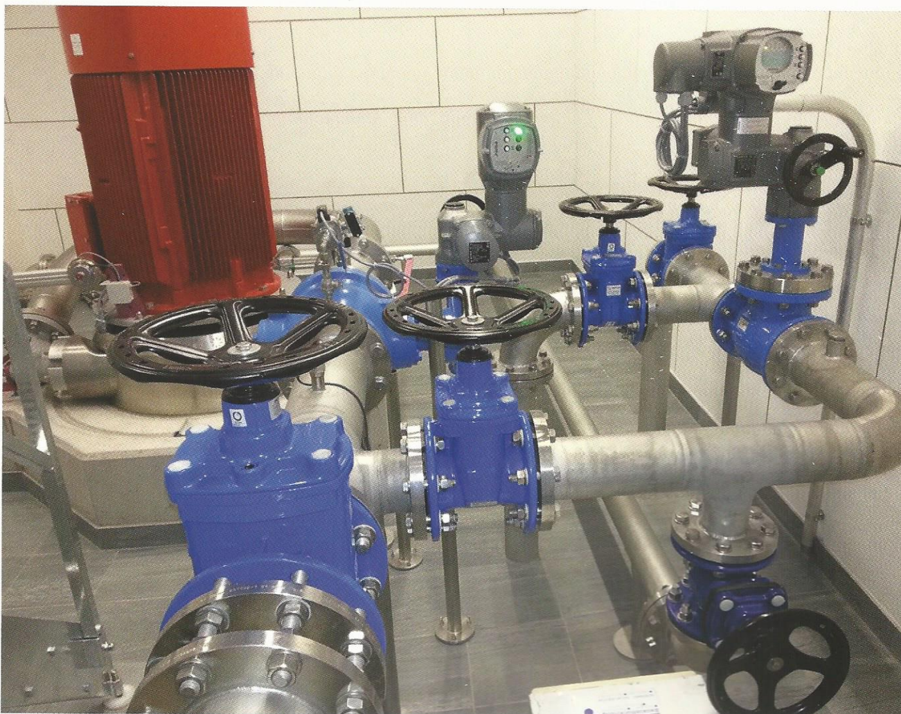
Armaturen-Anordnung im TWKW Gosmer
