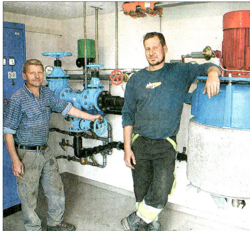
Ernst Ambauen (links) und Dominik Murer (rechts), Mitarbeiter des Gemeindegewerkes Beckenried, im neuen Trinkwasserkraftwerk Lanzig.
